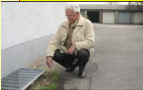
„Eigenhaus“-Vorstandsmitglied Wilhelm Blüter zeigt die an den Kellerschächten sichtbare Absenkung der Hofeinfahrt.
