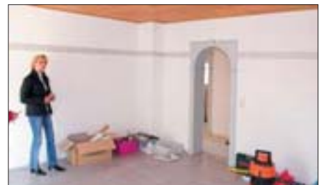
Familie Marschke zog auch wieder in ihre alte und jetzt komplett neue Wohnung zurück, baut sogar Rundbogentüren ein.
